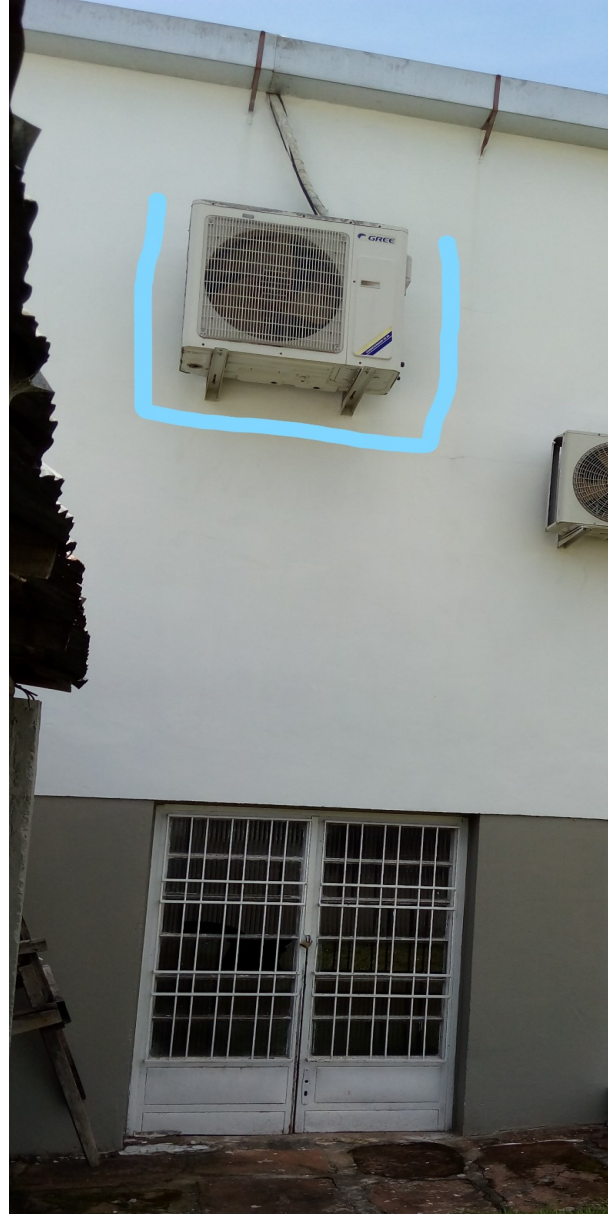
Foto 01 e 02: Evaporadora e condensadora do aparelho a que se refere o item 3.1.1.
