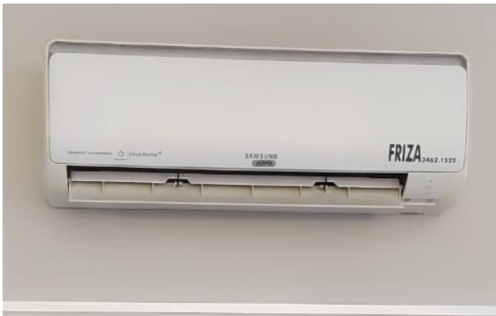
Foto 01: Evaporadora do aparelho, item 01.
