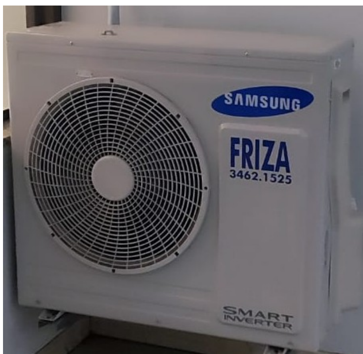
Foto 04: Condensadora do aparelho, item 02.
