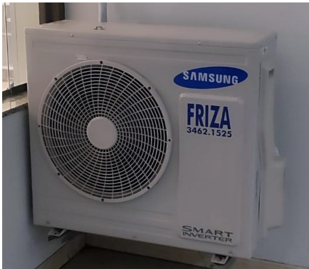
Foto 02: Condensadora do aparelho, item 01.
