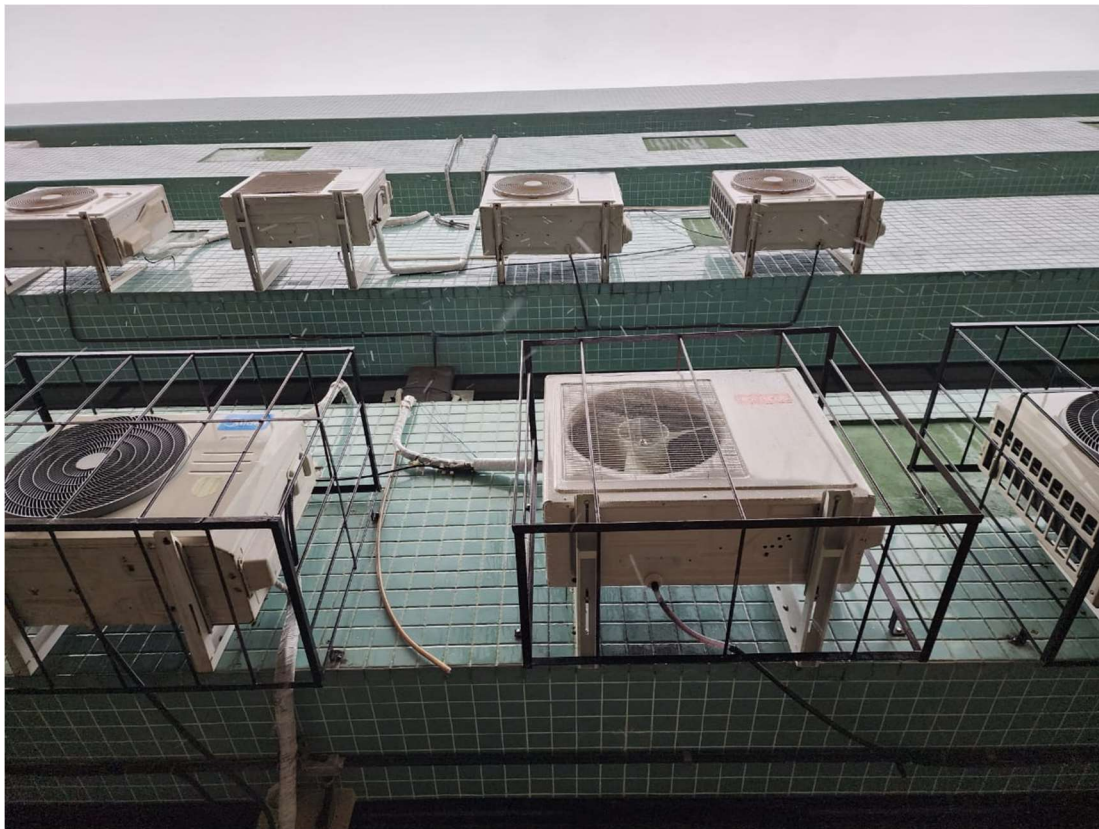
Foto 09: Local de instalação das evaporadoras dos equipamentos.
