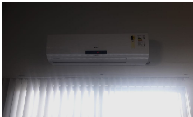
Foto 09: Evaporadora instalada no cartório da 41ªZE.
