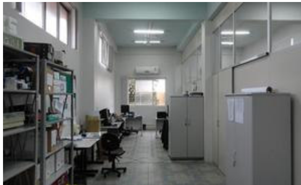
Foto 08: Evaporadora instalada no cartório da 41ªZE.
