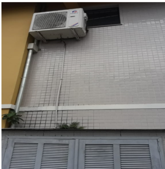
Foto 05: Condensadora ligada ao equipamento da foto 04.
