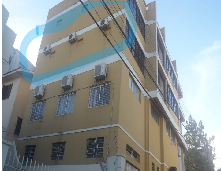
Foto 07: Condensadoras instaladas na lateral do prédio.
