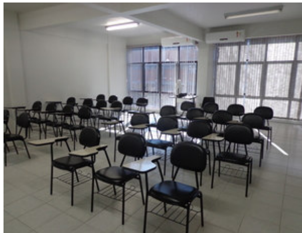
Foto 02: Evaporadoras localizadas no segundo piso.
