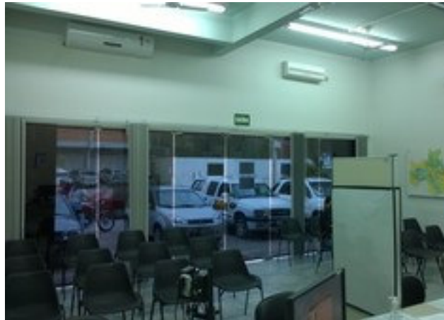
Foto 01: Evaporadoras localizadas na área de atendimento ao público.
