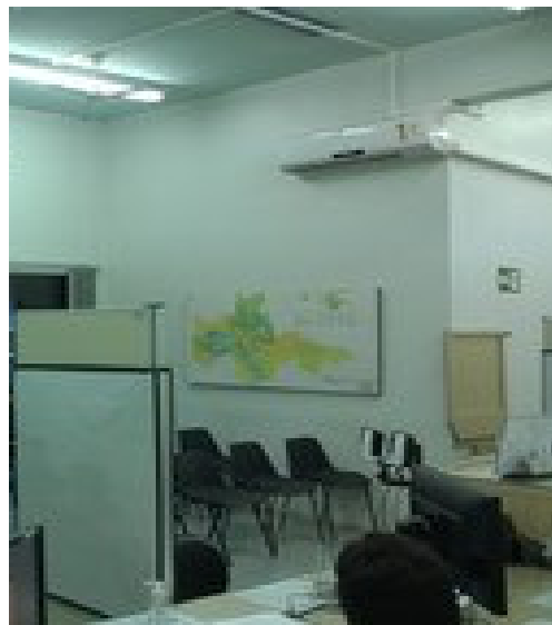
Foto 04: Evaporadora da área de atendimento ao eleitor.
