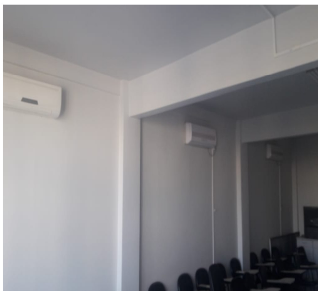
Foto 06: Evaporadoras instaladas no segundo pavimento.
