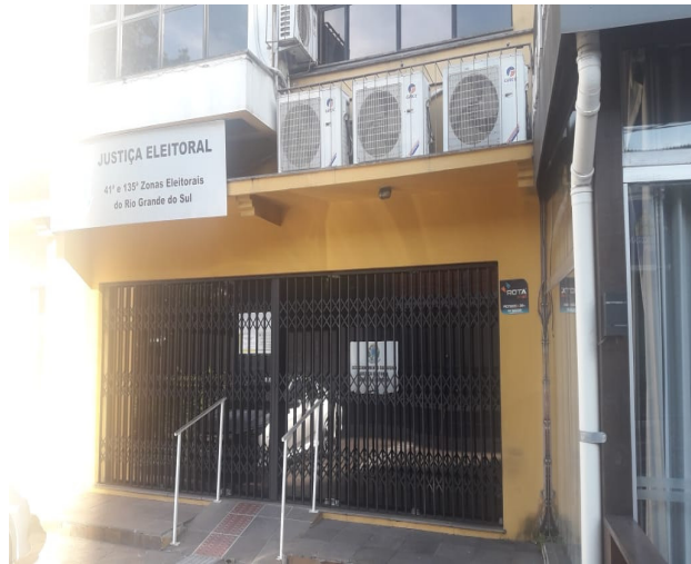
Foto 03: Condensadoras ligadas às evaporadoras das fotos 01 e 02.
