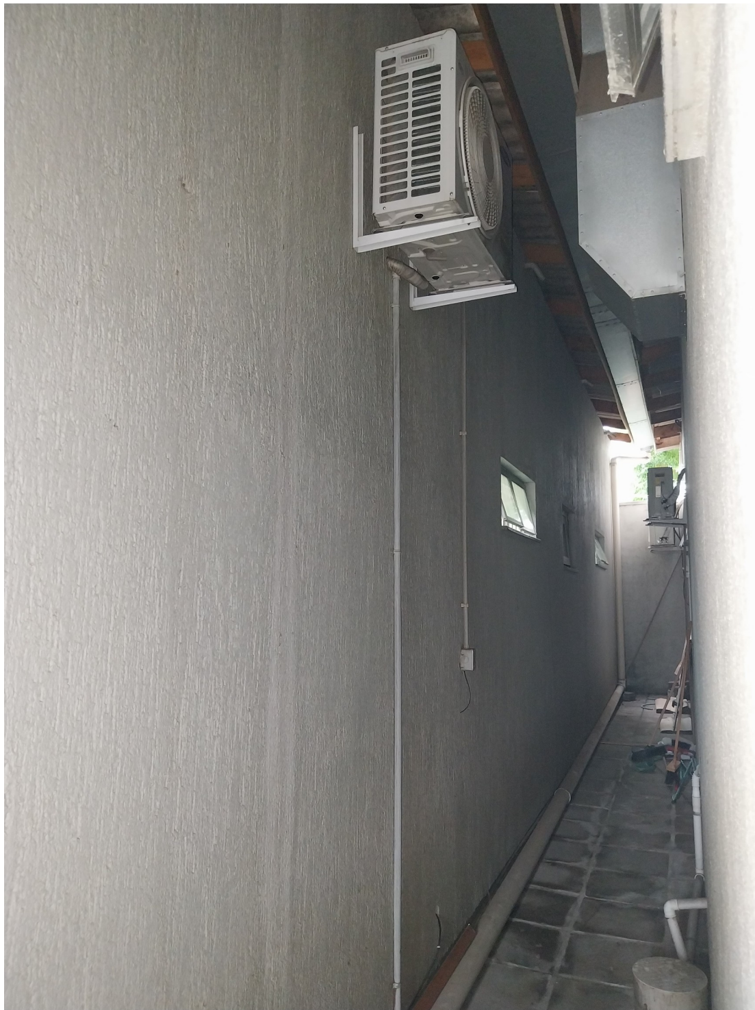
Foto 02: Condensadora do aparelho.
