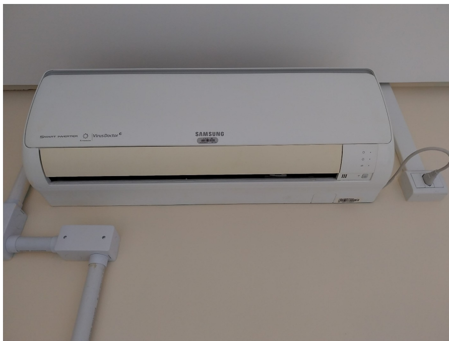
Foto 01: Evaporadora do equipamento.
