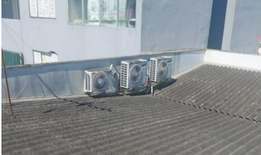
Foto 01: Condensadoras dos equipamentos referidos no item 3.1.
