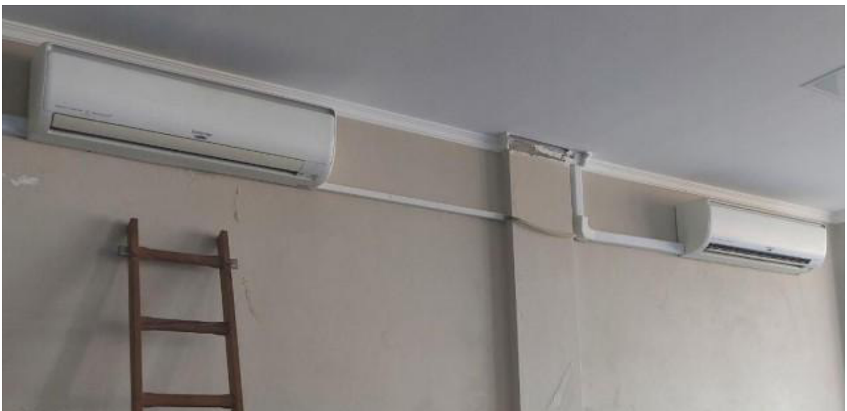
Foto 05: Evaporadora do equipamento referido no item 3.1.3 e 3.1.4.
