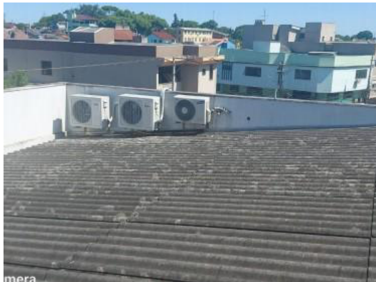
Foto 02: Condensadoras dos equipamentos referidos no item 3.1.
