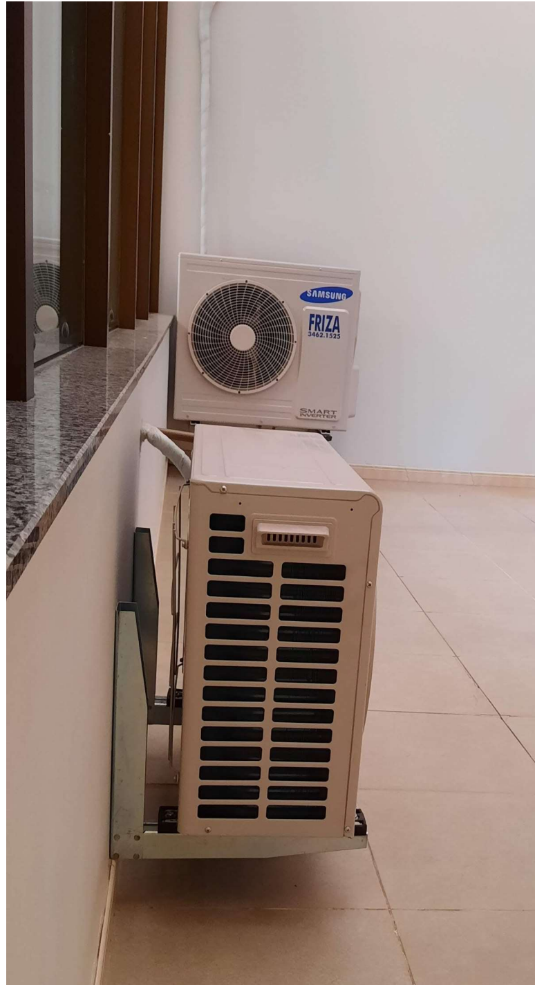
Fotos 3 – Situação de instalação das unidades condensadoras.
