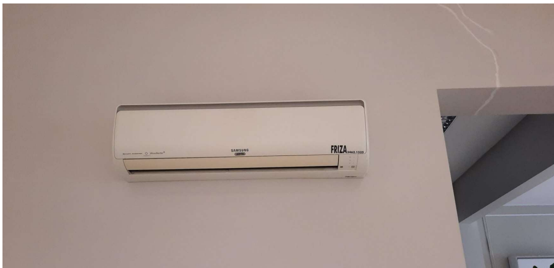
Foto 2 – Situação de instalação da unidade evaporadora, item 3.1.2.
